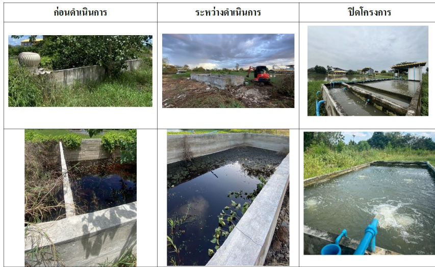
โครงการปรับปรุงระบบกรองน้ำก่อนเข้าสู่กระบวนการบำบัดน้ำเสีย
